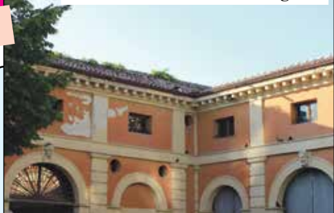
I tetti deteriorati del Bottagisio
