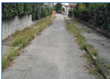
Erba selvaggia e sporcizia nello stretto corridoio di via Isonzo
